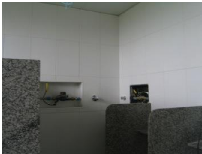
Figura 1 - Medição setorizada com transmissão dos dados por sinal 4-20 mA. Banheiro principal masculino, 4° andar.
