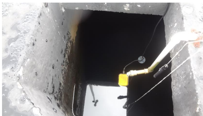
Figura 4 - Sensor para monitoramento do nível instalado no reservatório superior de um prédio do CAB – Centro Administrativo da Bahia.
